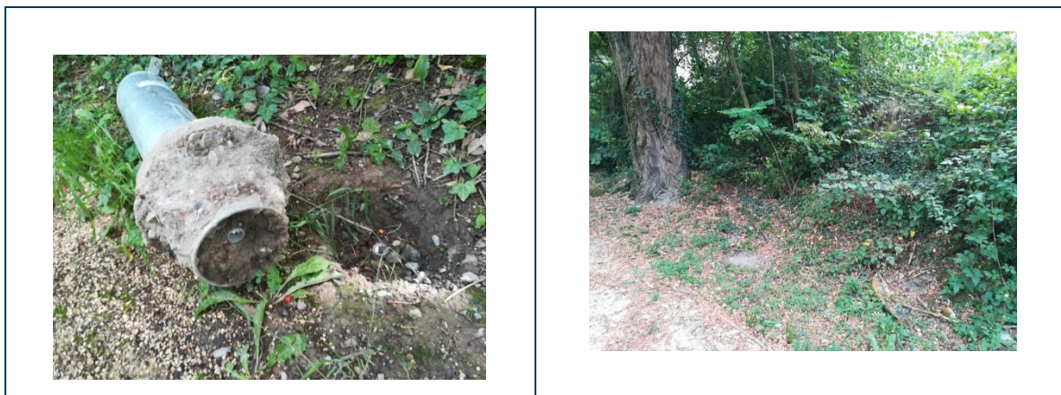
Fig. 4. Photos – Prz8 endommagé
