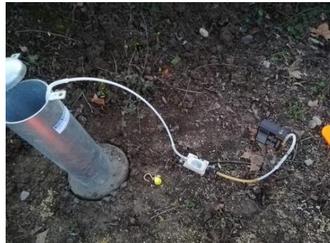
Equipements de prélèvement des gaz du sol
